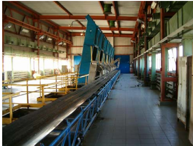
Fotografia 1: Taśmociąg transportujący skratki.
